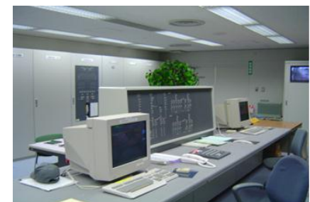
電気監視制御システム
